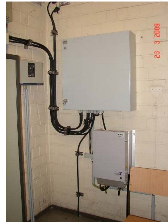
Neues Koppelnetzwerk & Repeater
