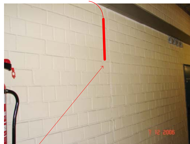
Omni-Antenne 2dBi senkrecht an Wand bei Fuge, unter Kabelkanal, in Schutzrohr.
