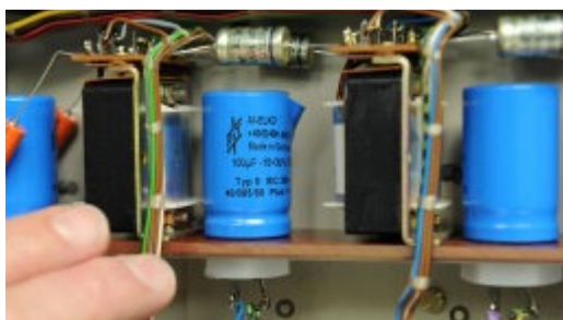
Ein solcher blauer Elektrolytkondensator war defekt und führte zu dem Komplettausfall.
